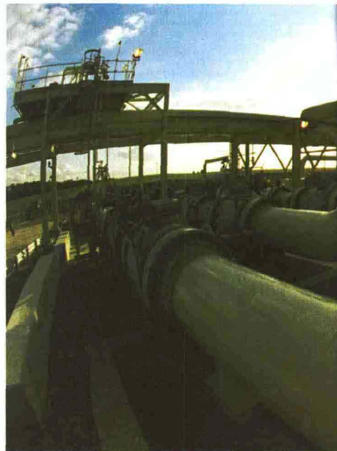
Mosca, un gasdotto Gazprom
